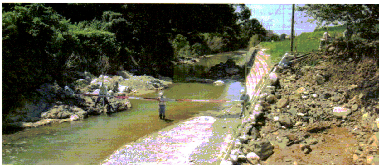
図-3 河川被災箇所の横断写真の例
