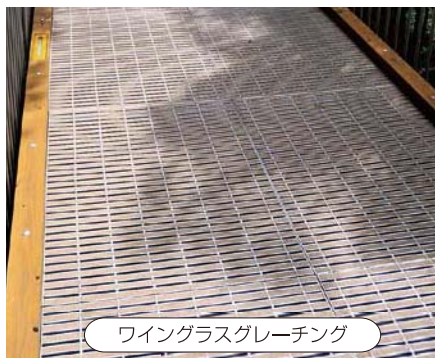
床板グレーチング
